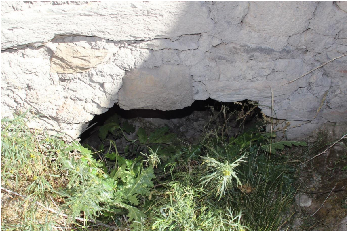
Figura 22. Orificio abovedado (posible osario) detrás del área del altar, ápice del ábside.
