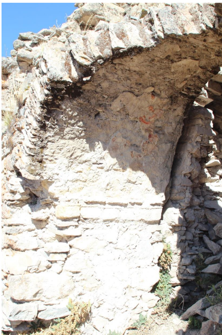
Figura 16. Detalle del arco portal, con restos del enlucido y pintura.
