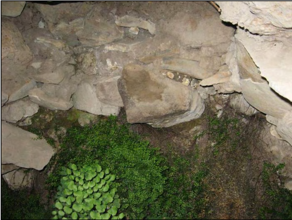
Figura 16. Vacio estructural (¿ex profeso?) en la base del muro posterior del altar de la iglesia de la reducción. Si este elemento fuera una constante en edificios similares a éste, entonces valdría la pena la apertura de una unidad de excavación hacia el oeste.
